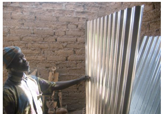
Nouvelles toitures fragiles en tôle
